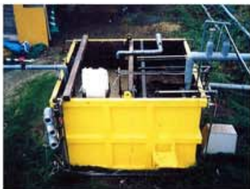
▲設置された超深層曝気槽(ヘッドタンク)
