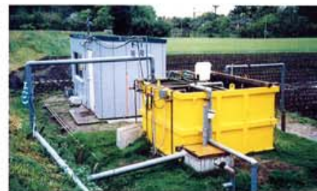
▲施設状況/超深層曝気槽(手前)と固液分離機(後方)
